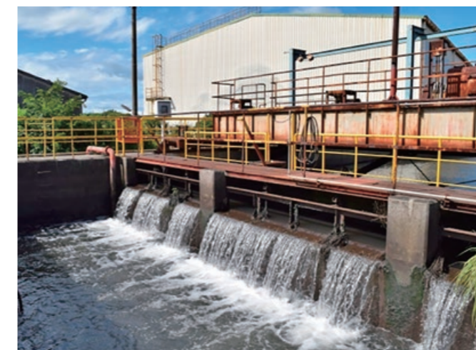
排水処理施設
