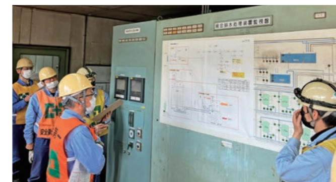
排水処理施設のパトロール
